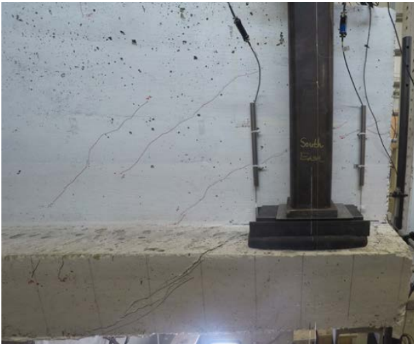
(d) South side at final load level
