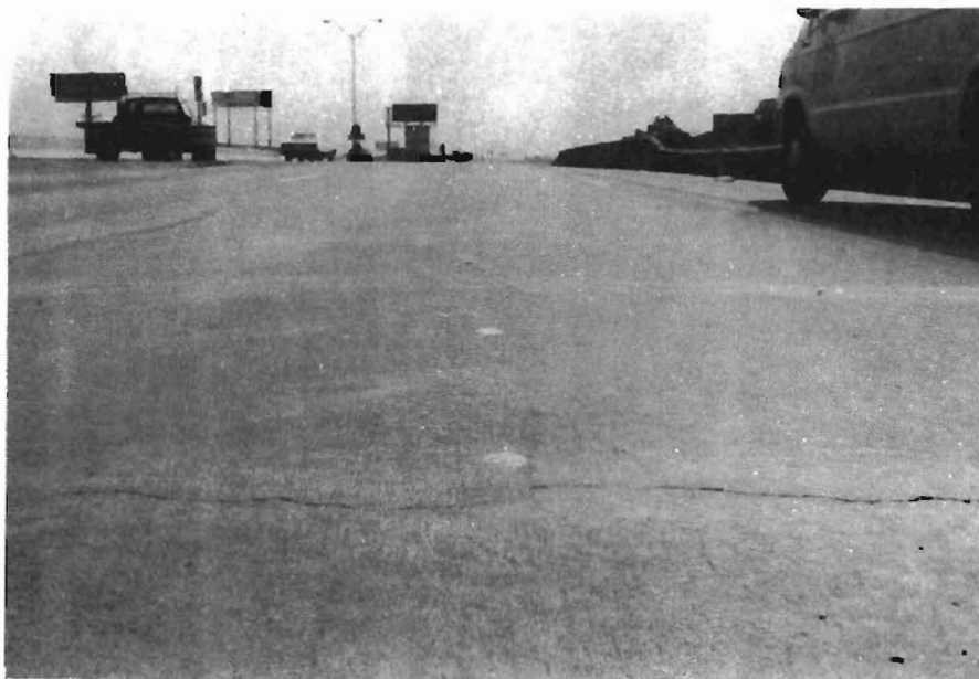
Fig 2.4. Transverse cracks -- original pavement.
