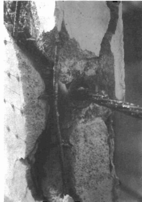
(d) Ultimate failure
