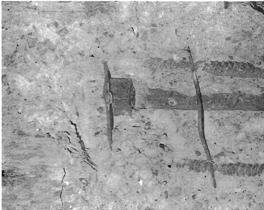
Fig. 9a. Fracture of bolt inside concrete
