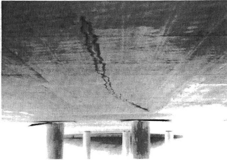
FIG. 14. Longitudinal Slab Cracks
