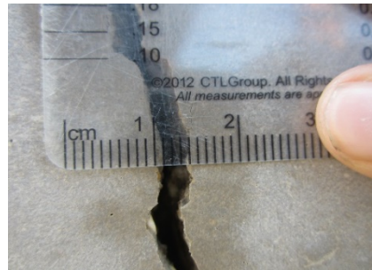
(d) Control maximum crack width measurement
