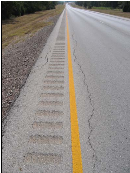
Figure 1.11. Edge Cracking in SH 47 IL from STA 2146.70 to 2149.18.
