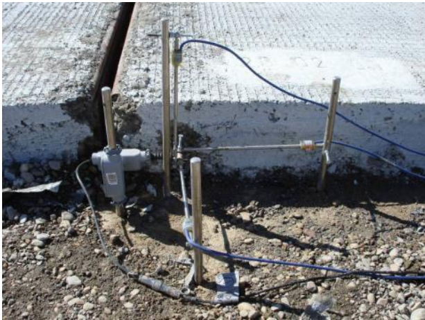
(d) Crackmeter at armor joint
